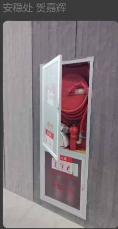
安稳处 贺嘉辉 星光剧场，消火栓箱体门变形了。
